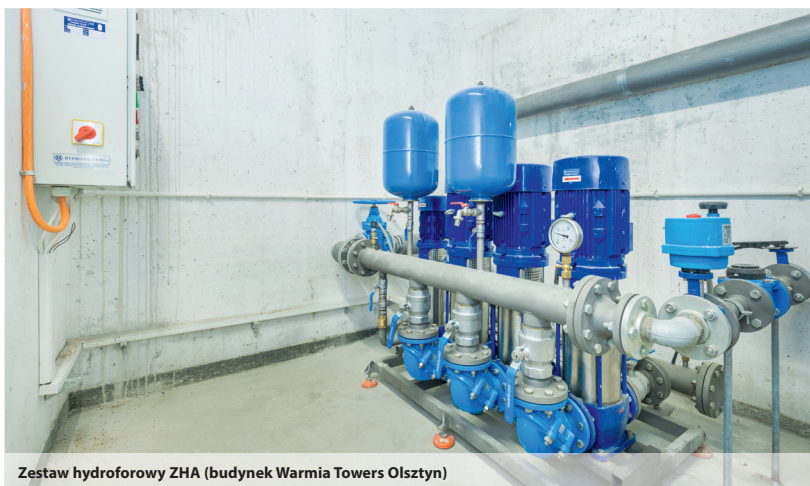
Zestaw hydroforowy ZHA (budynek Warmia Towers Olsztyn)
